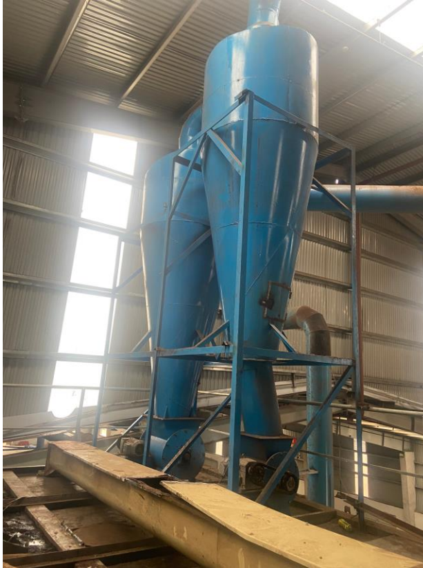
Hình 3.16. Thu hồi bụi tại khu vực ép viên và sàng viên sau ép
