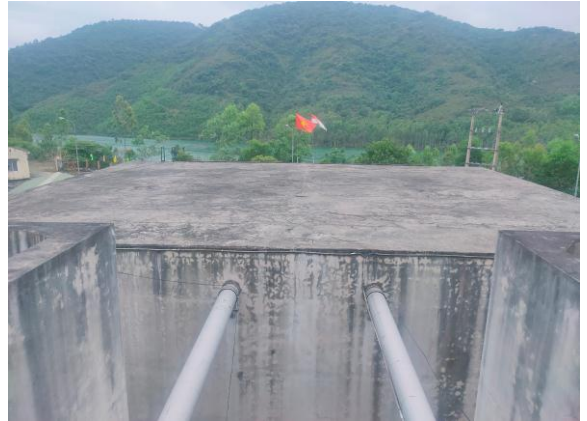
Bể chứa nước sạch
