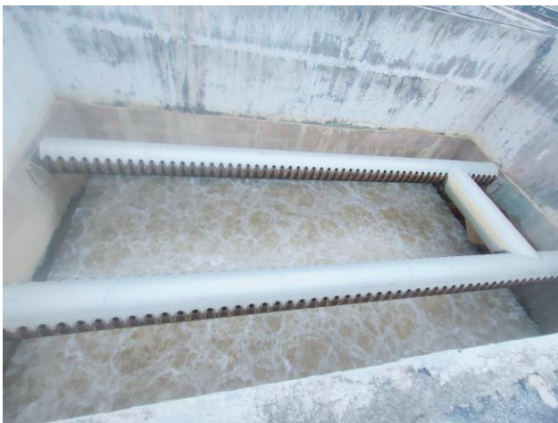
Bể lọc cát nhanh
