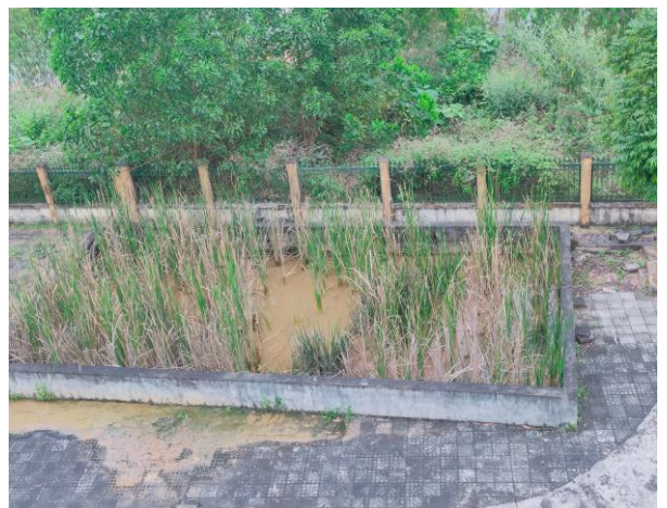
Bể lắng bùn
