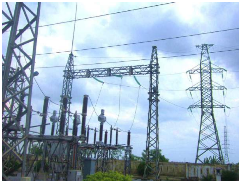
Hình 1.4. TBA 110kV Lệ Thủy
