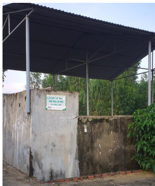
Bể lọc chậm
