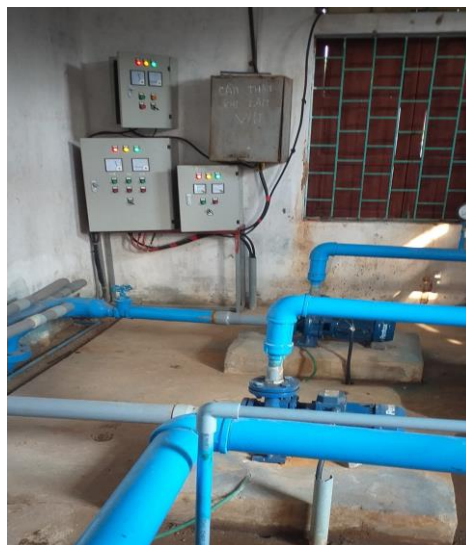
Trạm bơm cấp II
