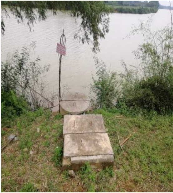
Hố thu nước và bơm chìm cấp I
