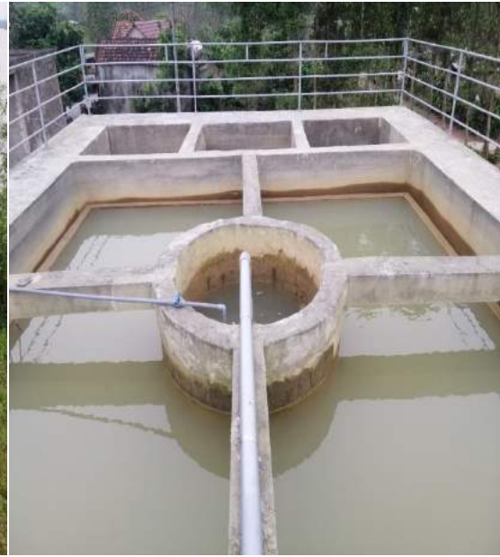
Cụm bể lắng lọc
