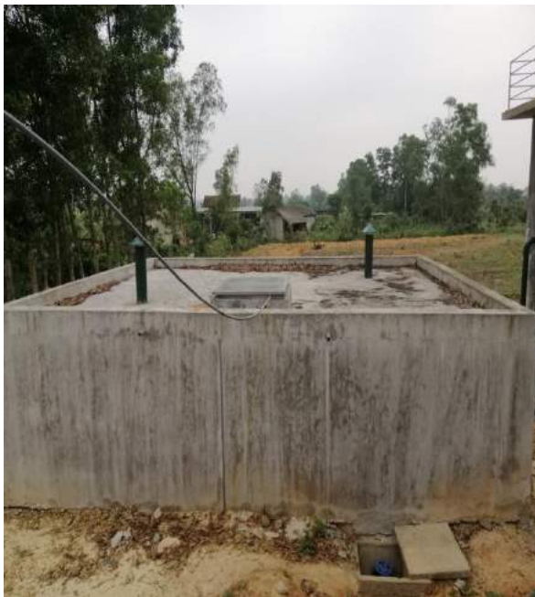
Bể chứa nước sạch
