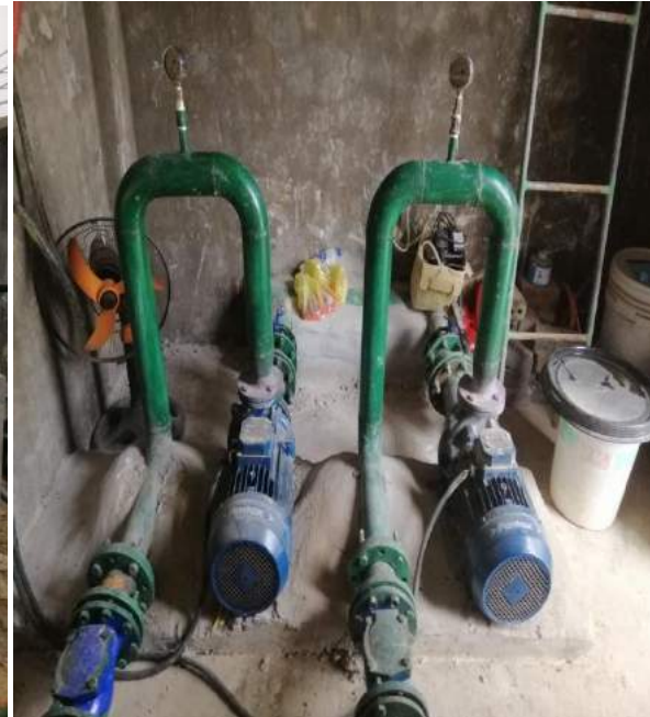
Trạm bơm cấp II
