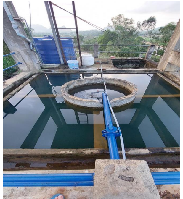
Bể lắng đứng
