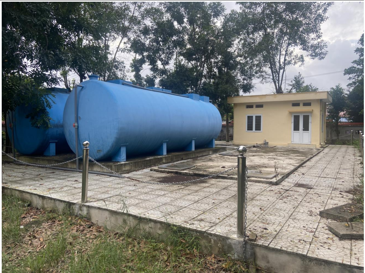
Hình 3.3. Hệ thống xử lý nước thải của Bệnh viện
