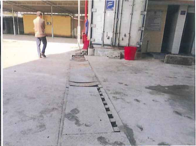
Mương dẫn nước thải sản xuất về hệ thống XLNT tập trung
