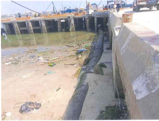
Đường ống D60 dẫn nước thải sau xử lý ra Sông Gianh
