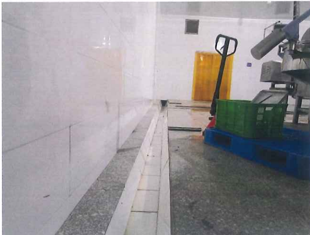
Mương thu gom nước thải rửa nguyên liệu và vệ sinh thiết bị, nhà xưởng
