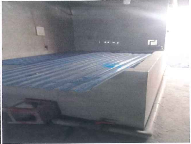
Bể hấp thụ của hệ thống xử lý bụi, khí thải
