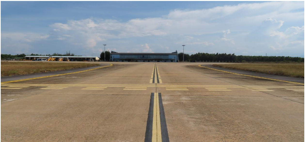
Hình 1.6. Hiện trạng đường lăn nối E2.
