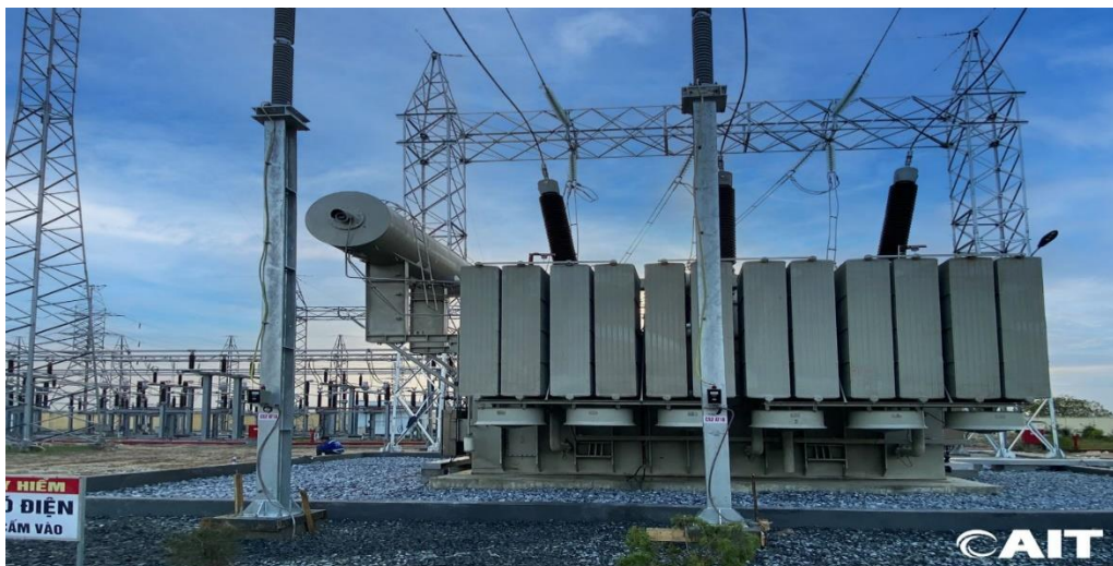
Hình 1.5. Máy biến áp 125MVA tại Trạm biến áp 220kV Ba Đồn
