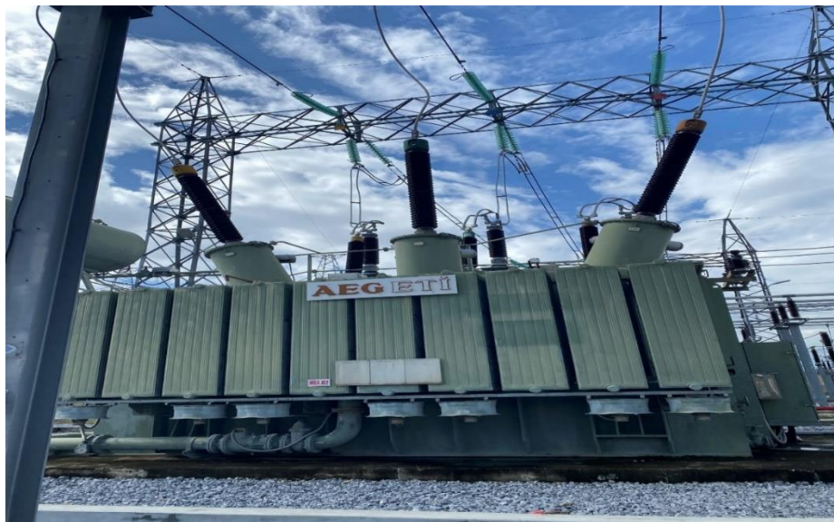
Hình 3.3. Máy biến áp của cơ sở
