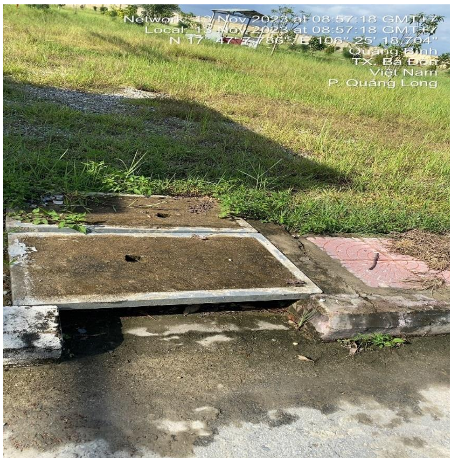
Hình 3.2. Hố ga nước mưa tại Trạm biến áp 220kV Ba Đồn
