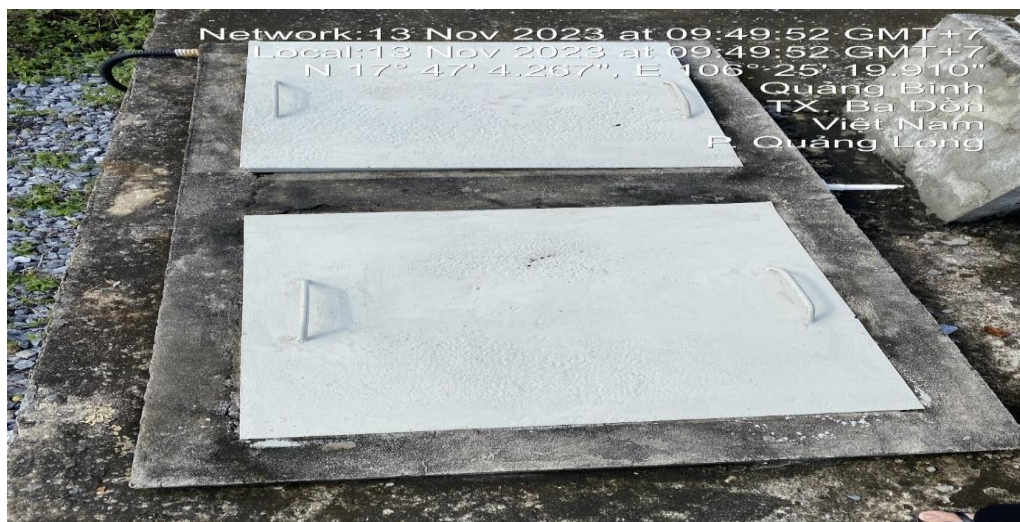
Hình 3.15. Bể dầu sự cố tại 2 máy biến áp
