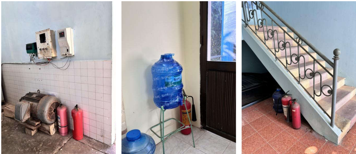
Hình 15: Trang thiết bị phòng cháy chữa cháy tại Nhà máy nước
