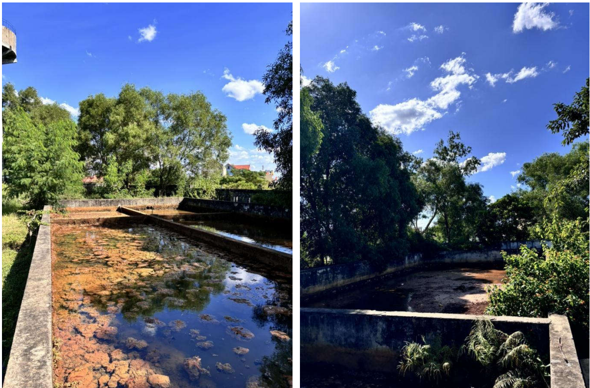
Hình 14: Công trình xử lý nước thải
