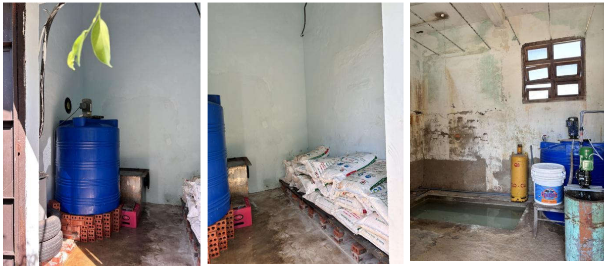
Hình 16: Kho hoá chất tại Nhà máy nước Hải Thành
