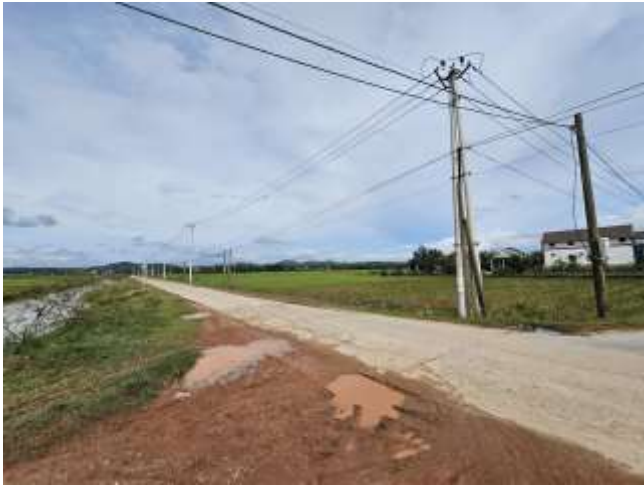
Hình ảnh đường 22kV
