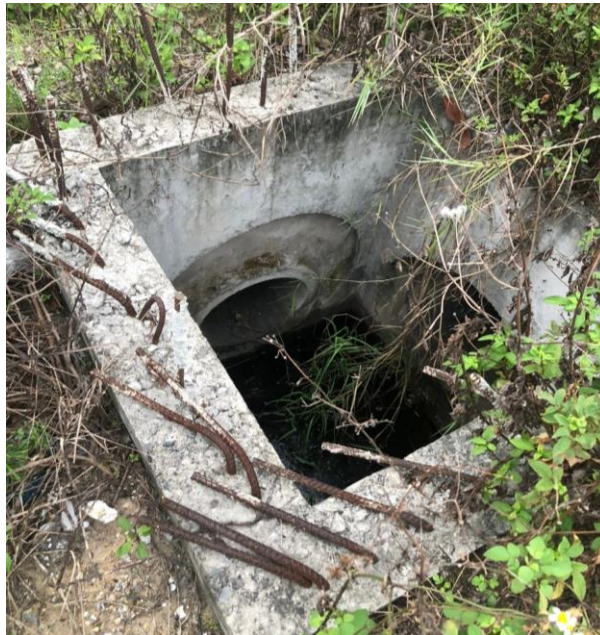
Hình 9. Hố ga thoát nước mưa khuôn viên bên ngoài của cơ sở kích thước 1,1 x 1,1 x 1,1 (m)
