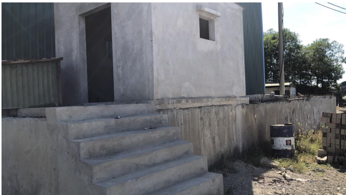
Hình 16. Hình ảnh bể chứa nước cứu hỏa của cơ sở
