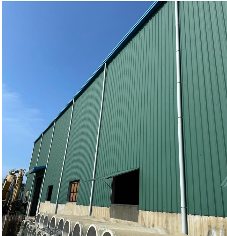
Hình 7. Hệ thống mương, ống thu nước mưa của nhà xưởng
