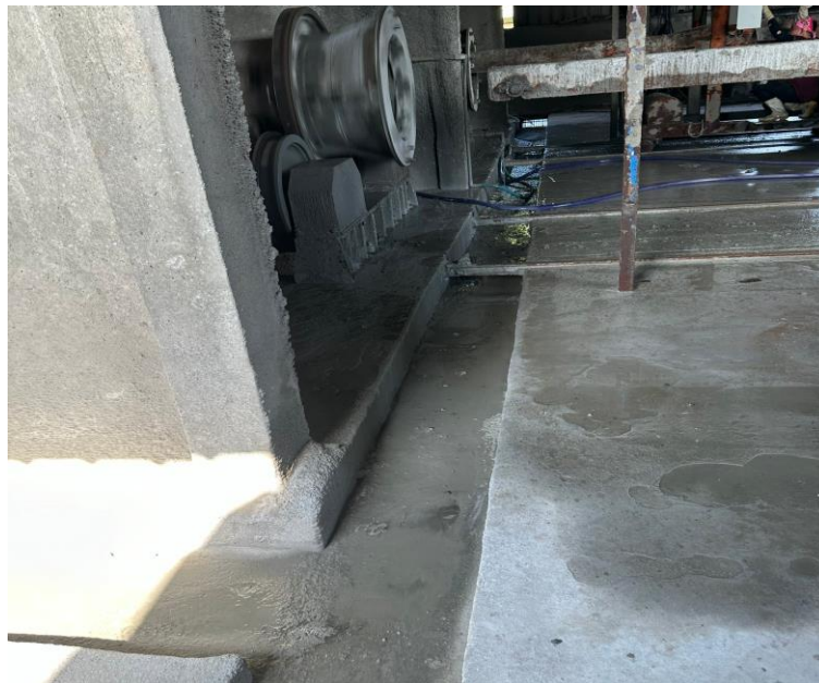
Hình 9. Mương BTXM thu nước thải tại khu vực bê tông ly tâm Bể lắng lọc 03 ngăn xử lý nước thải khu vực sản xuất bê tông ly tâm:
