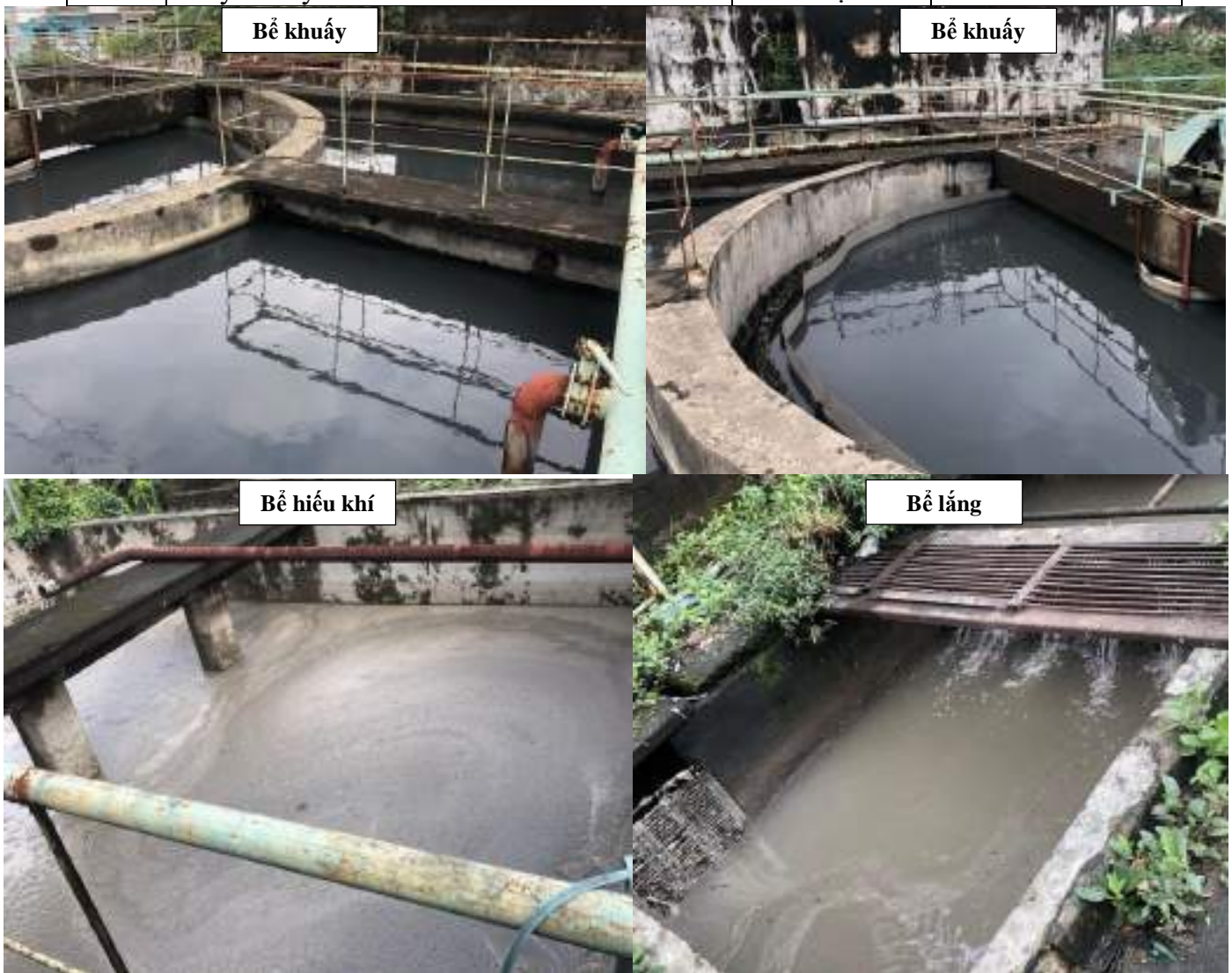
Hình 14. Hệ thống xử lý nước thải sản xuất của cơ sở
