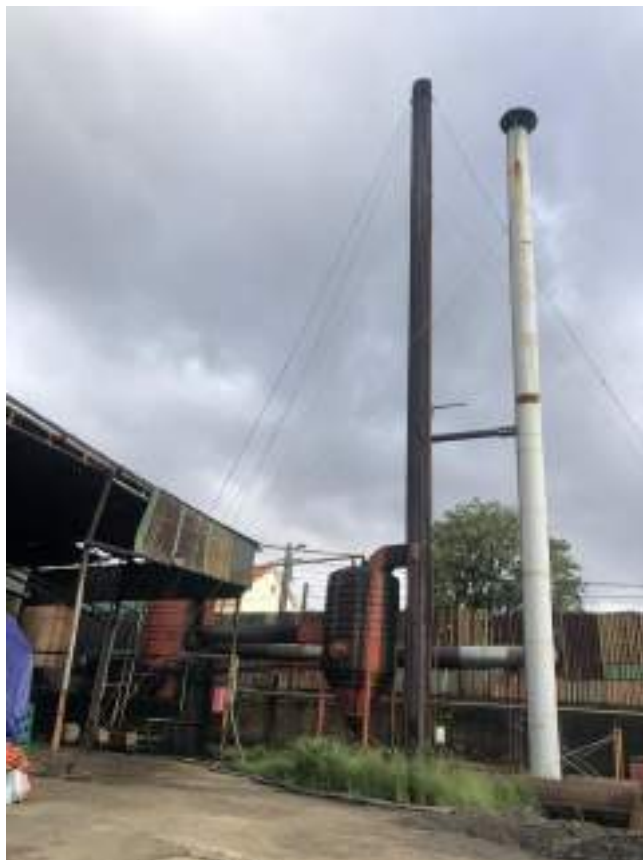
Hình 17. Hệ thống xử lý khí thải của cơ sở
