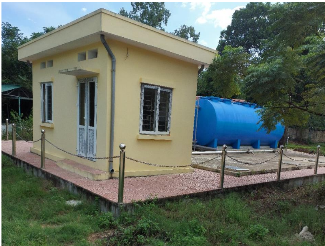
Hình 12. Nhà điều khiển và hệ thống xử lý nước thải của Bệnh viện
