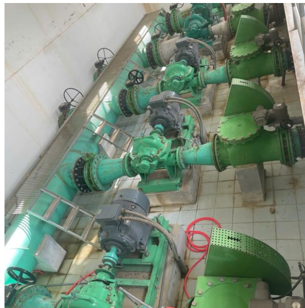
Hình 4: Trạm bơm cấp II
