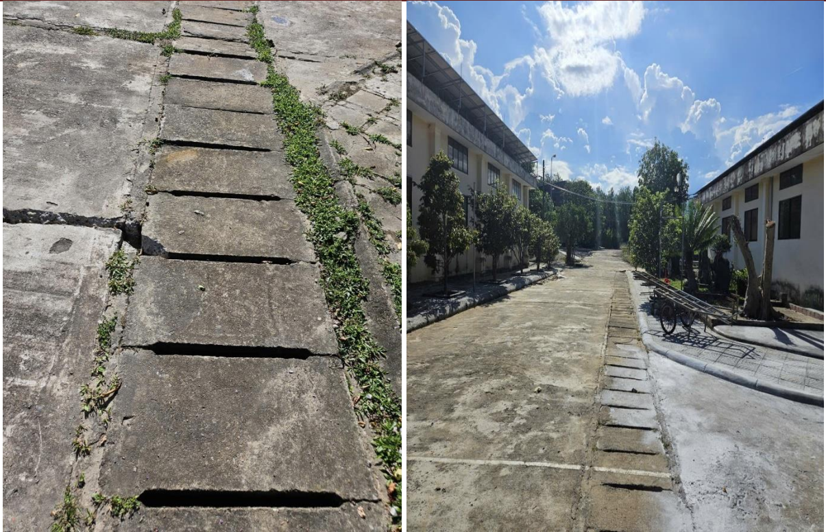
Hình 8: Hình ảnh mương thoát, rãnh thoát tại Nhà máy nước Phú Vinh
