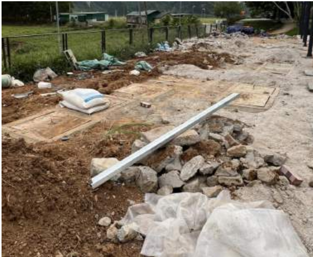
Hình 14. Hệ thống xử lý nước thải của Cơ sở
