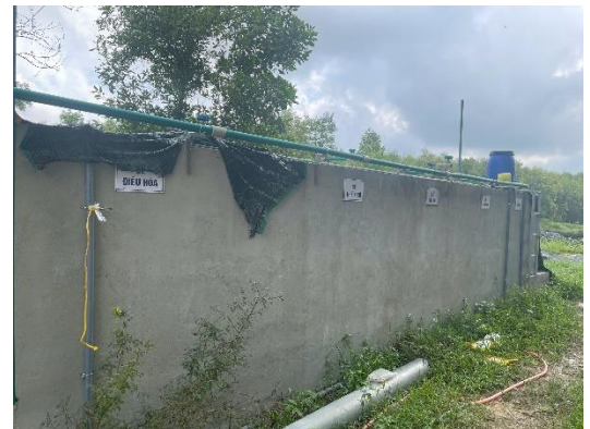
Hệ thống xử lý nước thải A-SBR
