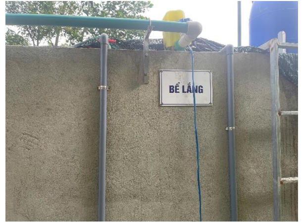
Hình 9: Bể hiếu khí 2
