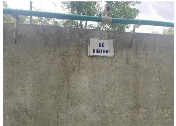
Hình 7: Bể hiếu khí 1
