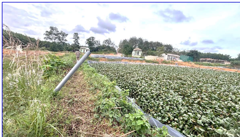
Đường ống uPVC D90 dài 50m thoát nước thải sau xử lý
