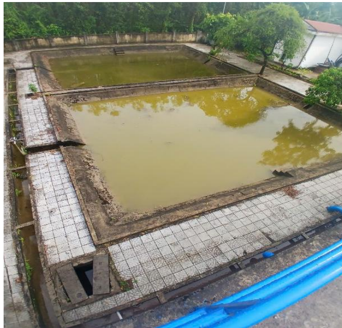
Hình 3.7. Bể xử lý nước thải
