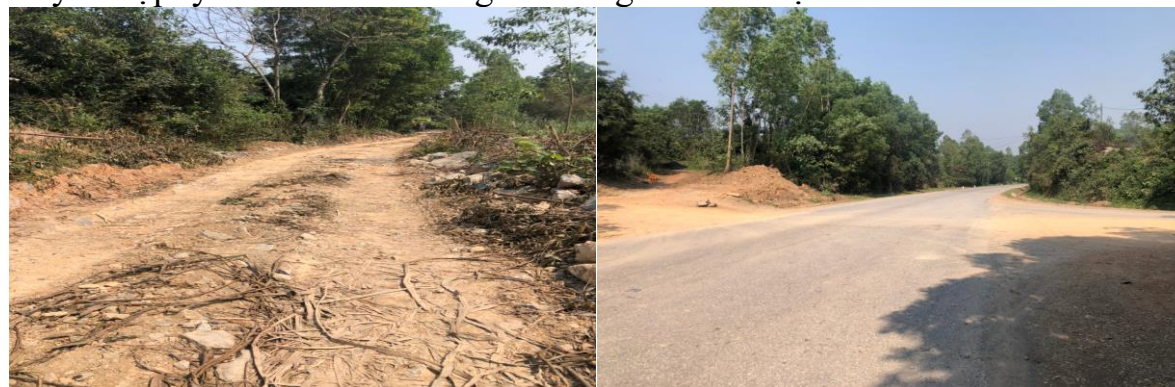
Hình 1.5: Hiện trạng đường giao thông đoạn giao với đường HCM
