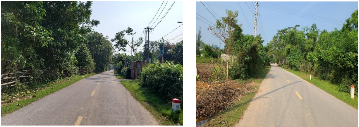
Hình 1-3. Hiện trạng tuyến đường tỉnh lộ 561 dẫn vào dự án
