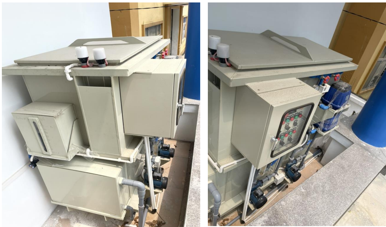
Hình ảnh: Hệ thống xử lý nước thải tập trung (dạng hộp khối)
