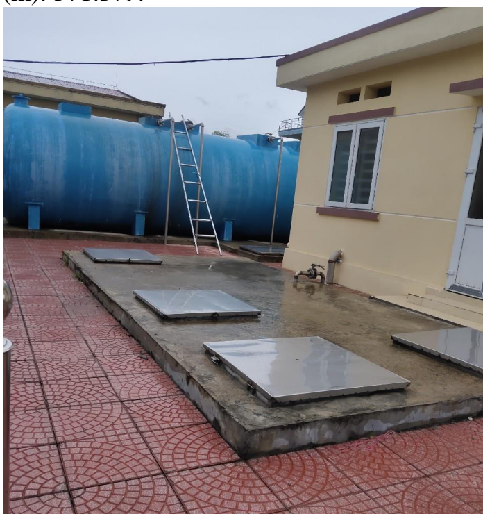
Hình 3.6. Hệ thống xử lý nước thải của Bệnh viện
