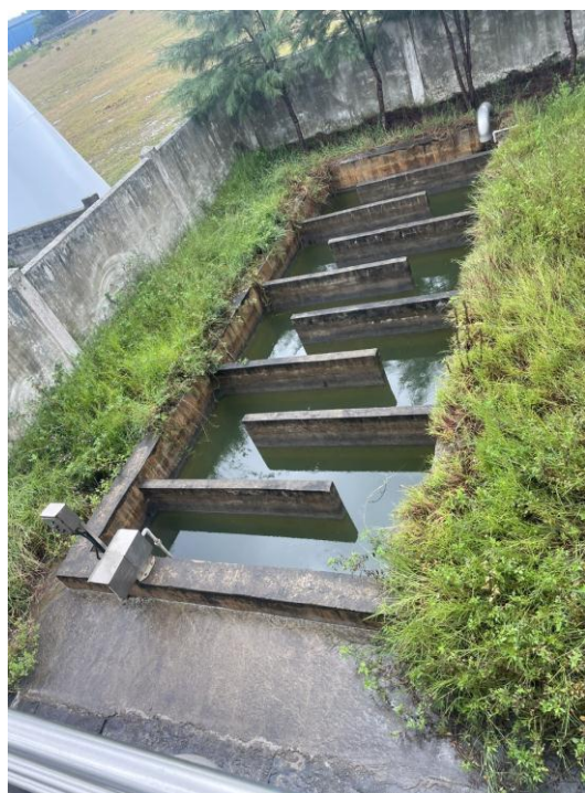
Bể khử trùng
