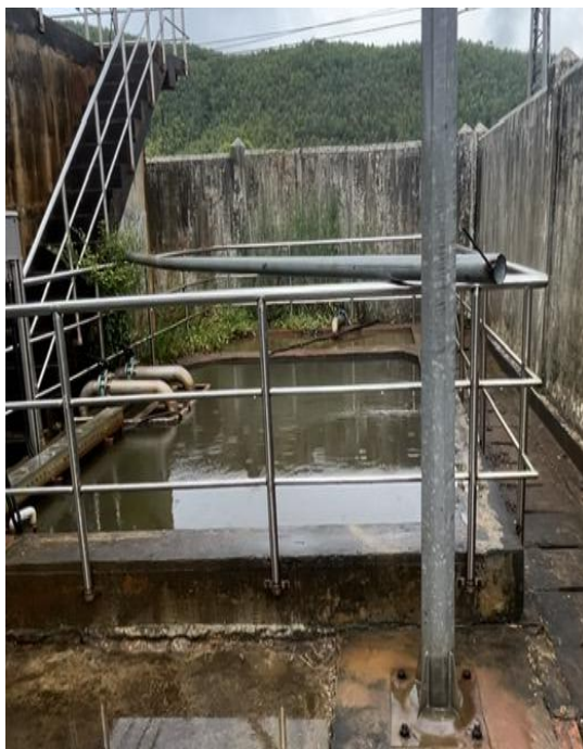
Bể điều hòa
