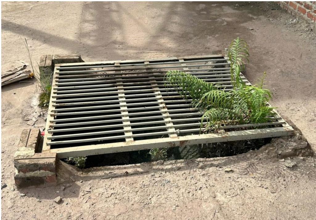
Hình 13. Hồ ga thu gom nước mưa của Xí nghiệp
