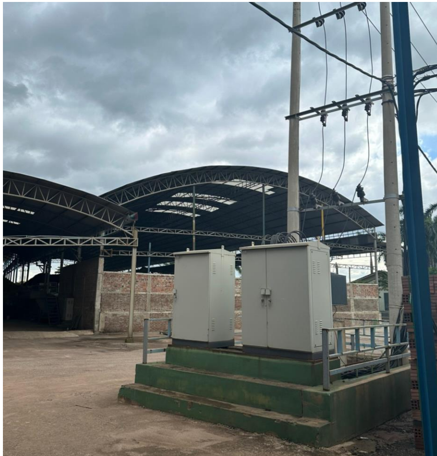
Hình 9. Máy biến áp của cơ sở
