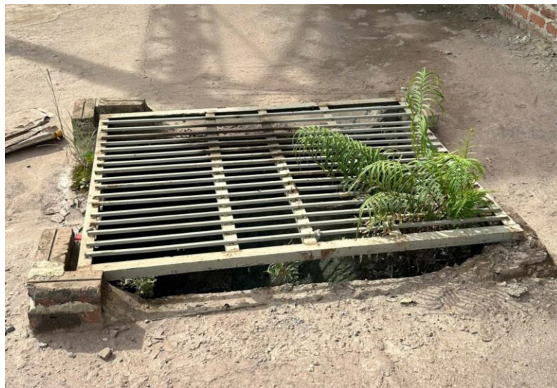
Hình 13. Hố ga thu gom nước mưa của Xí nghiệp
