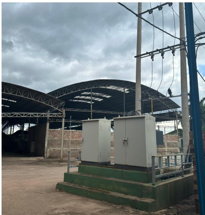
Hình 9. Máy biến áp của cơ sở
