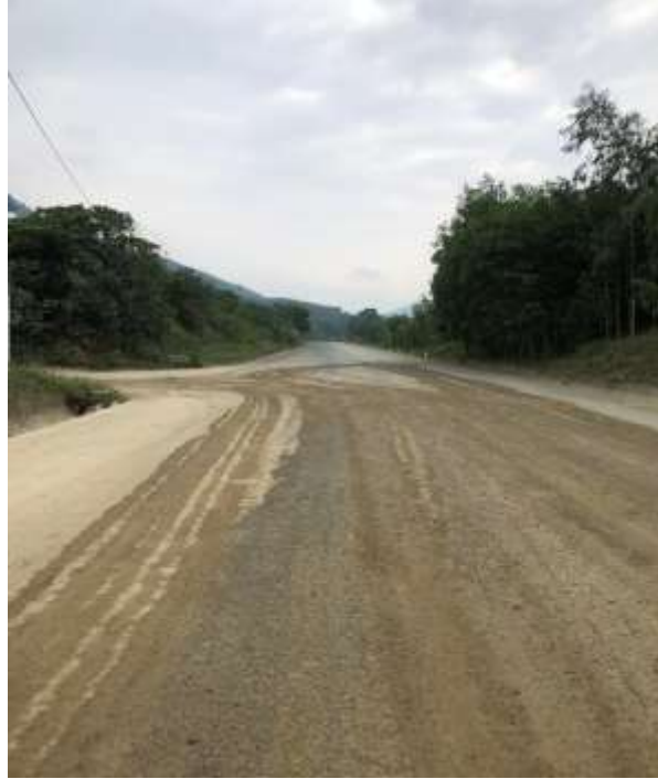
Hiện trạng Tuyến đường tỉnh lộ DT22 Hình 1.3: Hiện trạng các tuyến đường giao thông
