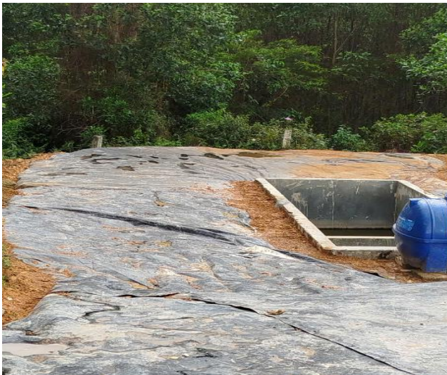
Bể khử trùng
