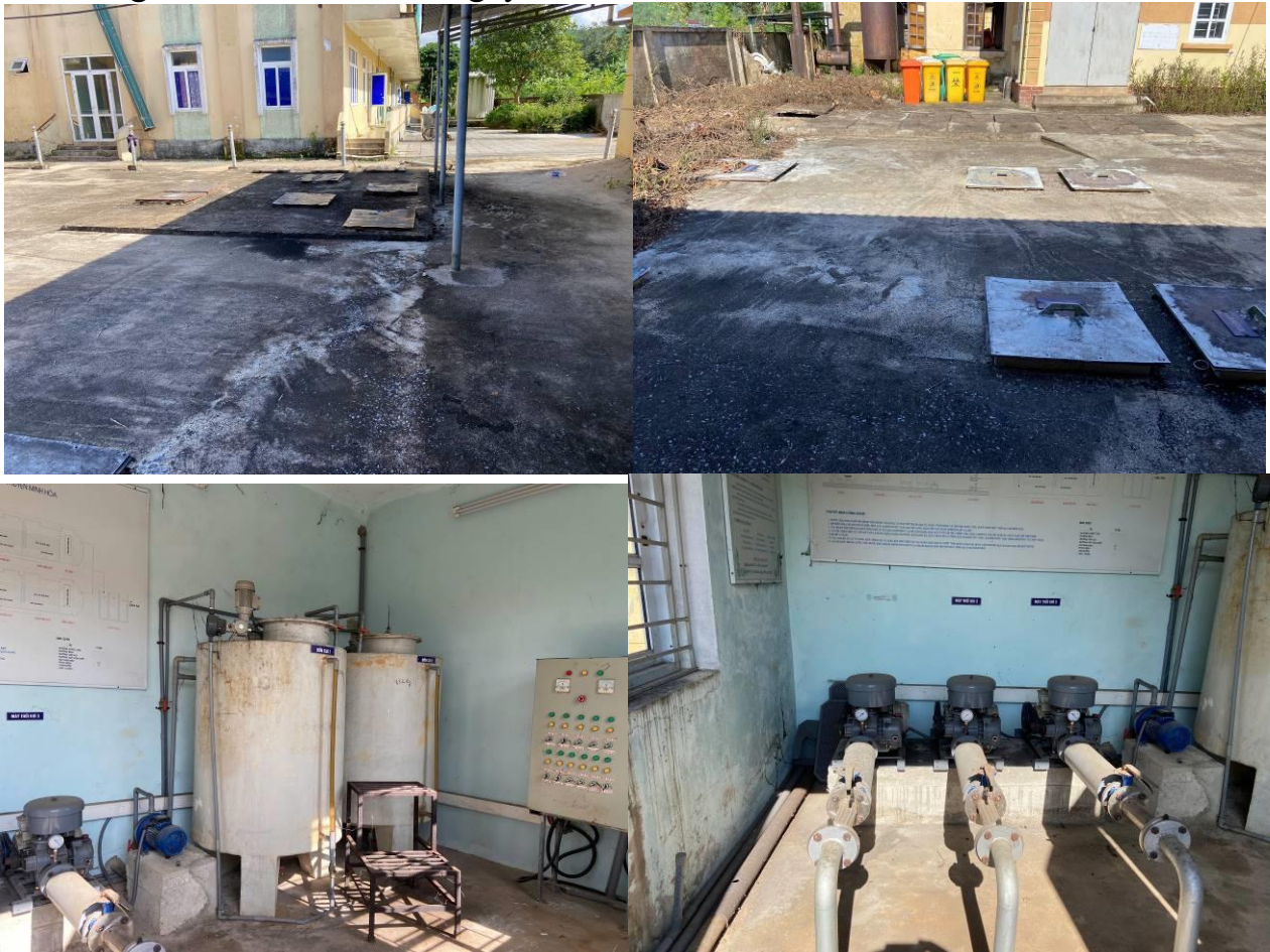
Hình 3.6. Hệ thống xử lý nước thải của Bệnh viện
