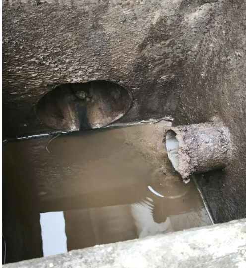
Hình 7. Hố ga và đường ống thu gom
