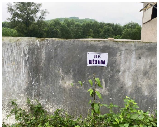
Hình 12. Bể điều hoà
