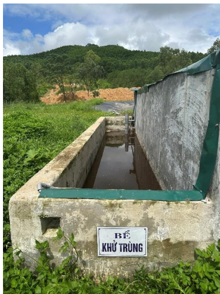
Hình 17. Bể khử trùng
