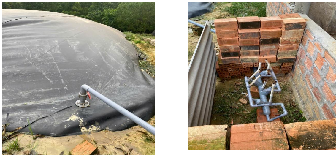
Hình 21. Đường ống dẫn khí và hệ thống đốt khí biogas
