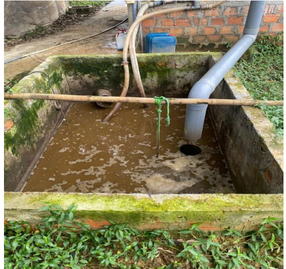
Hình 8. Bể tiếp nhận nước thải
