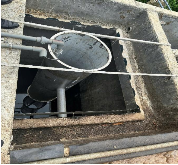
Hình 11. Bể lắng sinh học
