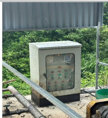
Hình 18. Tủ điện HTXLNT
