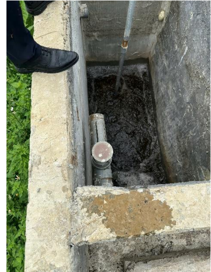
Hình 12. Bể khử trùng
