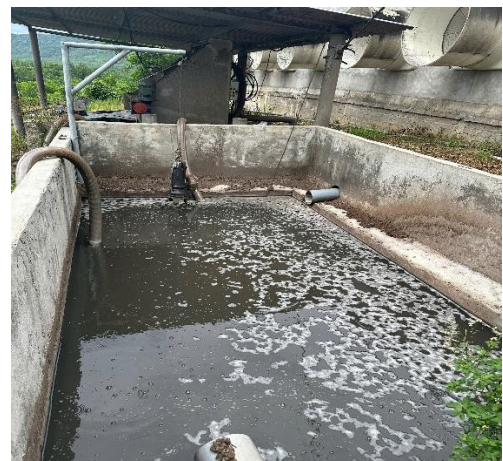
Hình 16. Bể thu gom
