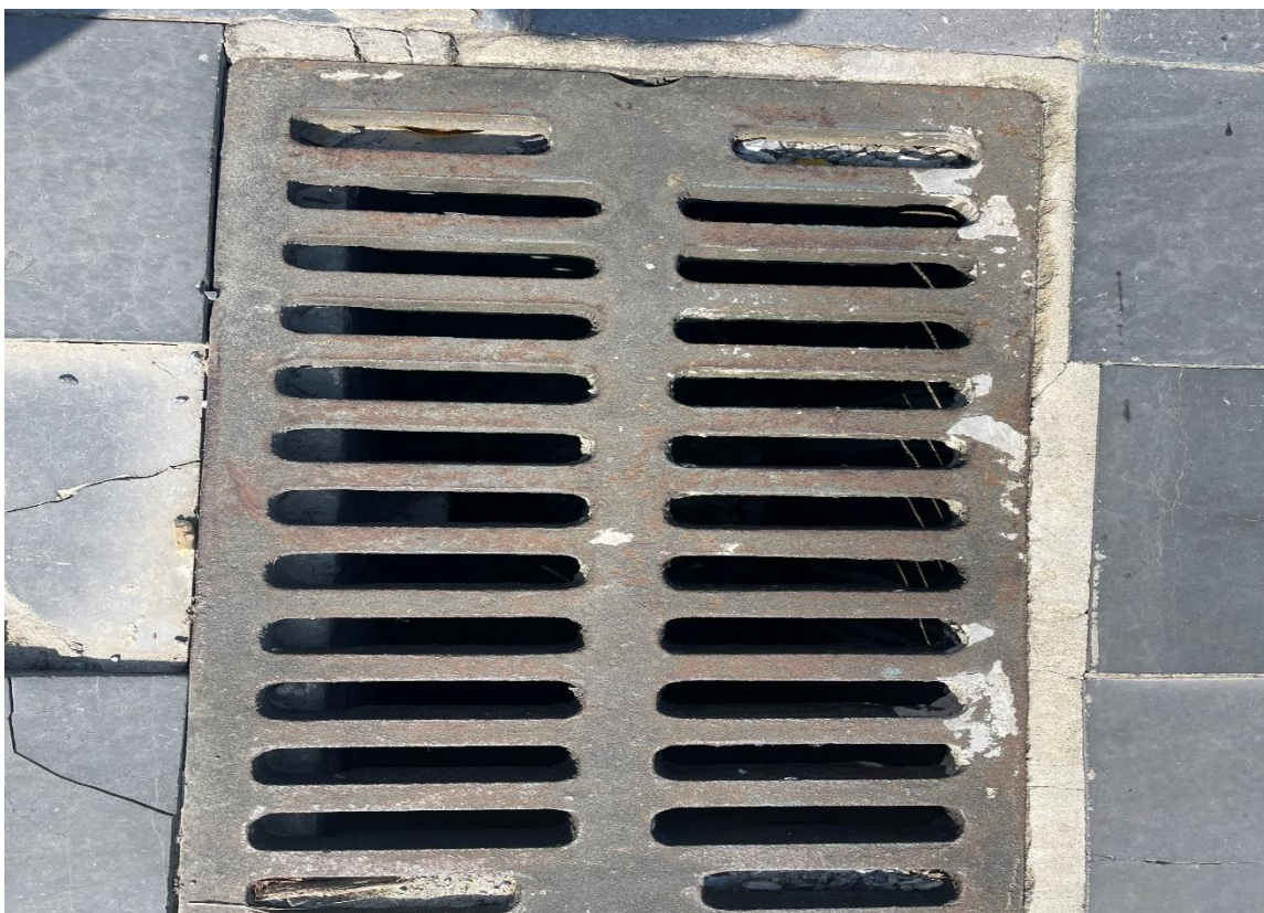
Hố ga thu nước mưa
