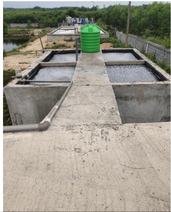
Hình 3.9. Bể tuần hoàn
