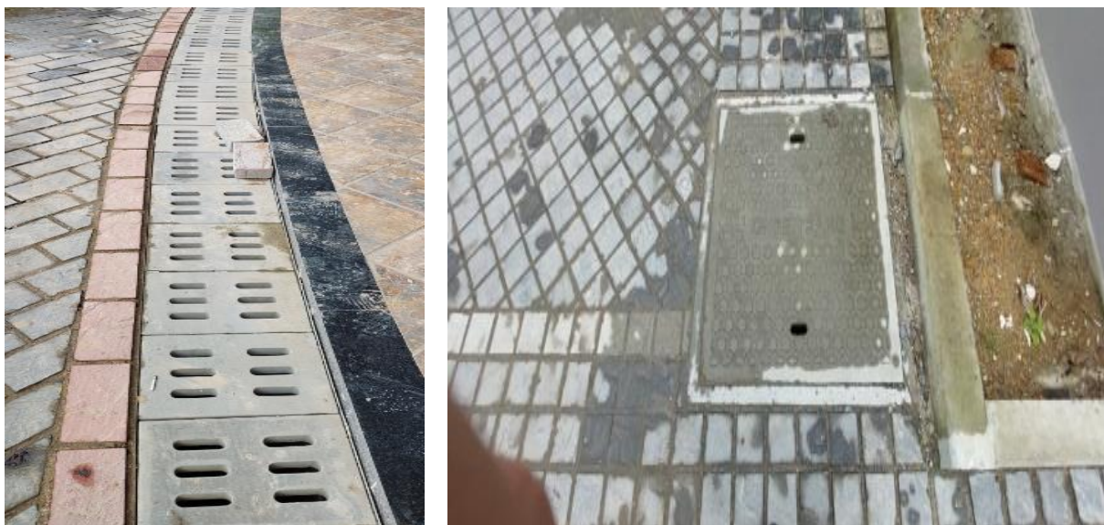
Hình 1. 10. Mương thoát và hố ga thu gom nước mưa.
