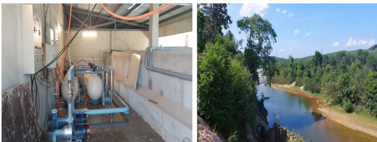
Hình 1. 6. Điểm khai thác nước và công trình xử lý
