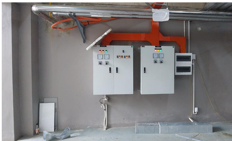
Hình 3. 10. Tủ điện được lắp đặt đúng theo quy chuẩn kỹ thuật được đặt ở mỗi khu chức năng
