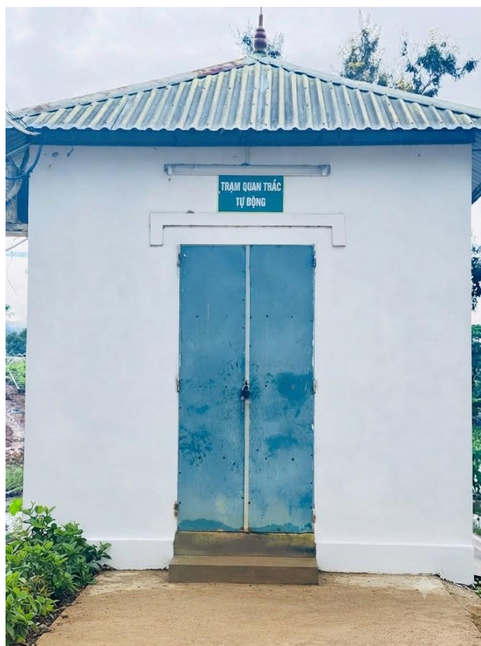
Hình 3.12. Trạm quan trắc nước thải tự động, liên tục
