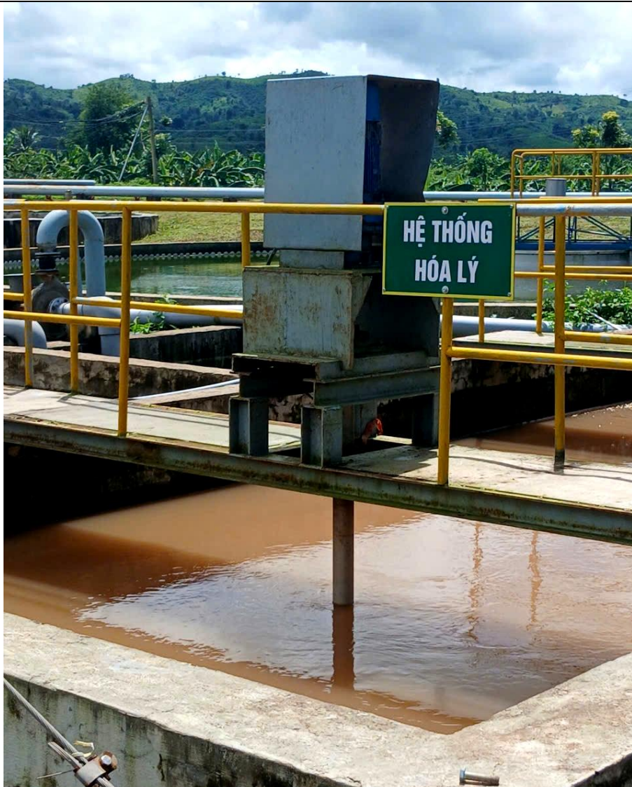
Bể keo tụ - tạo bông
