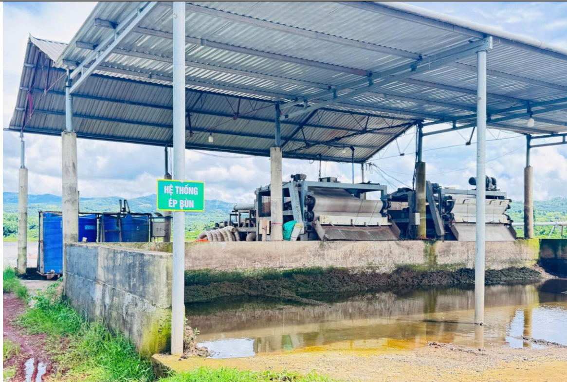
Hệ thống ép bùn
