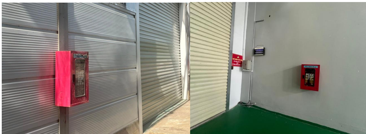
Hình 3.24. Một số hình ảnh các trang thiết bị PCCC của công ty
