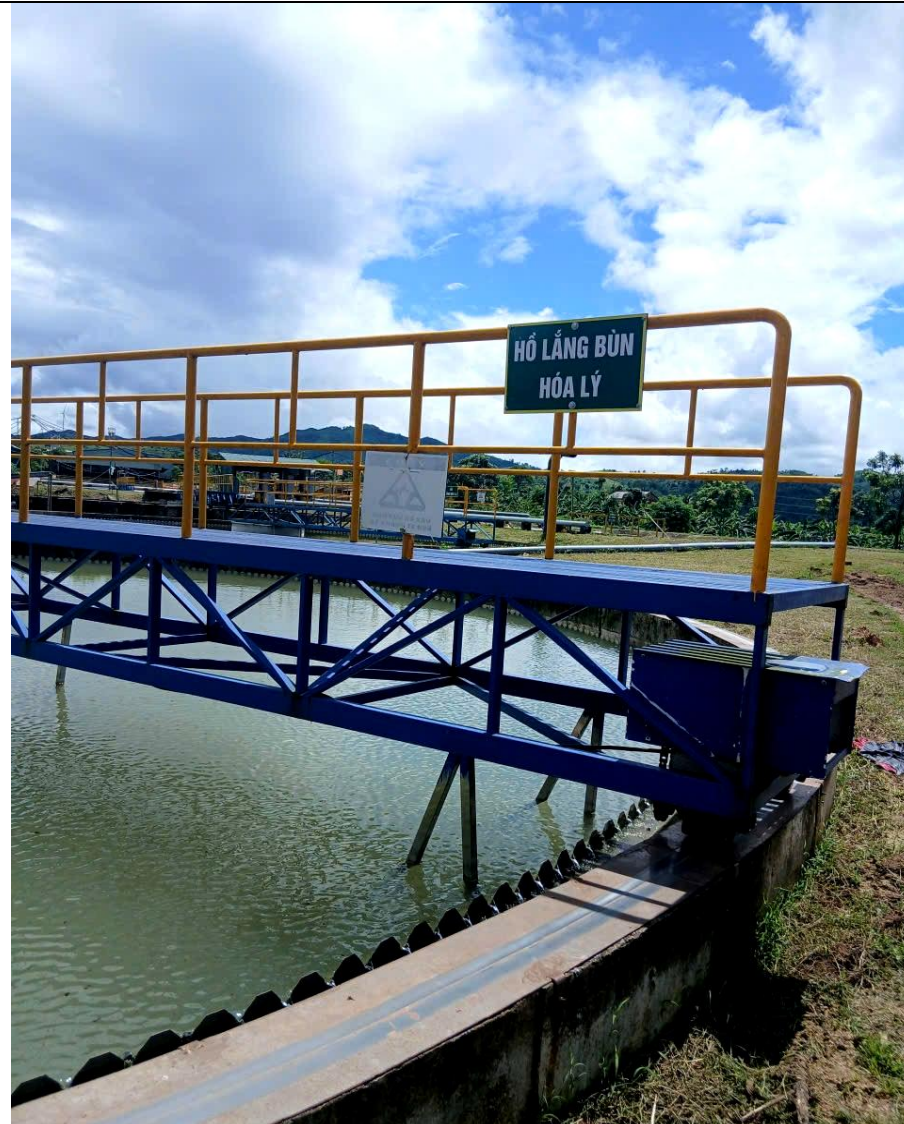
Bể lắng hóa lý
