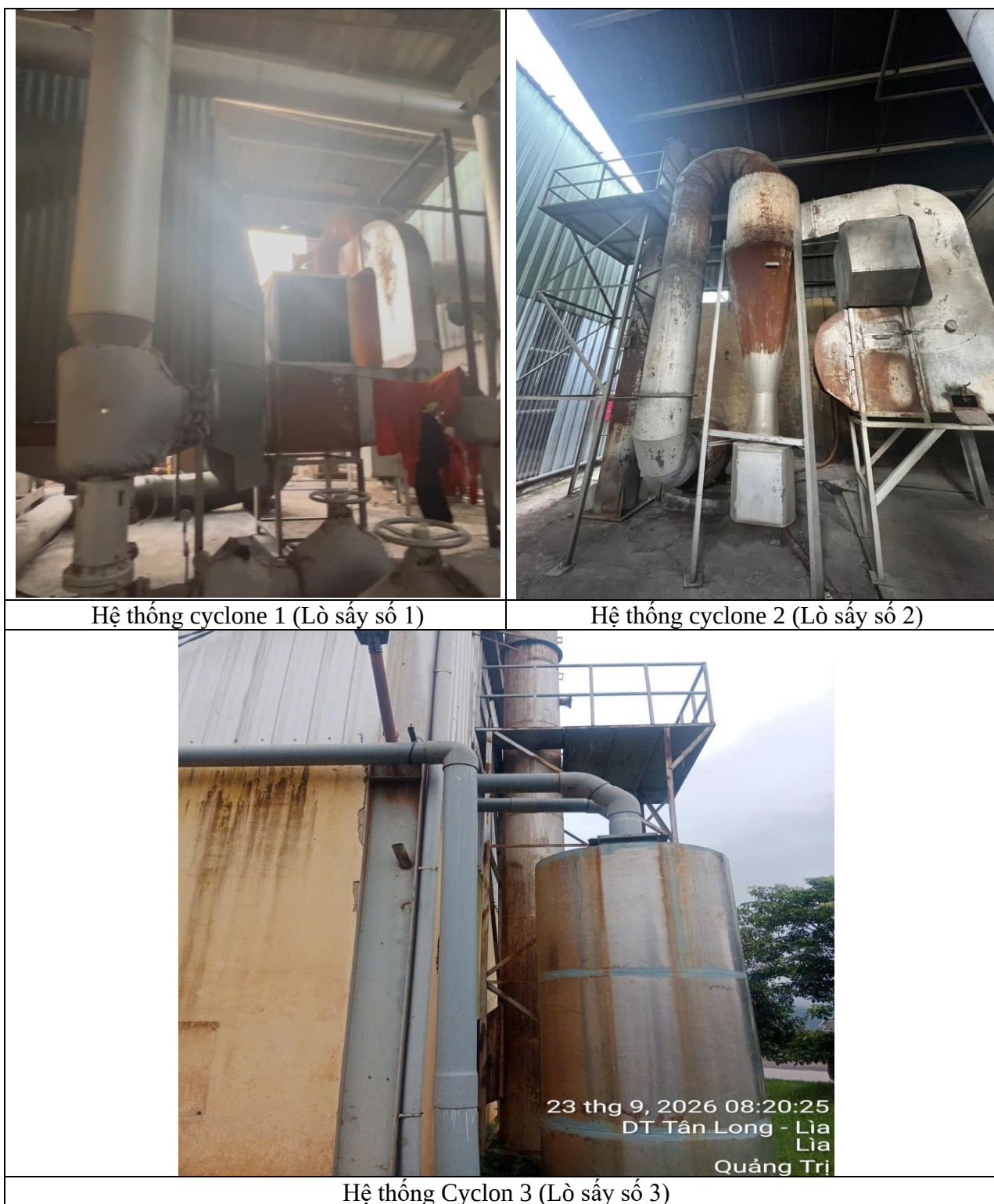
Hình 3.15. Hệ thống xử lý bụi thải công đoạn sấy
