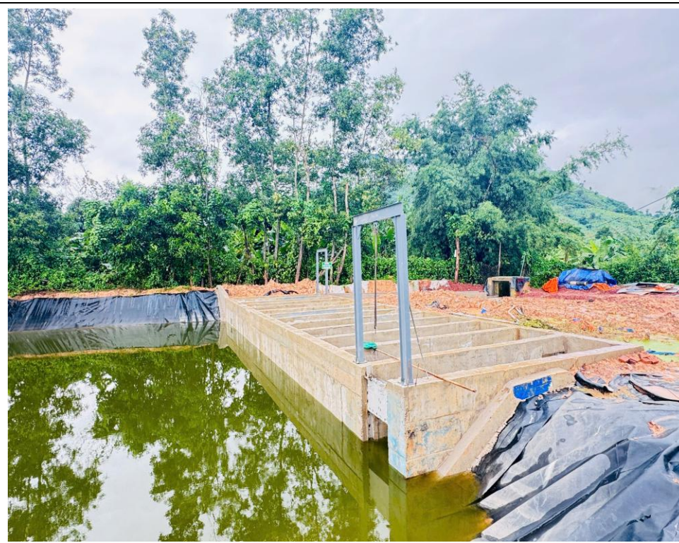
Bể khử trùng
